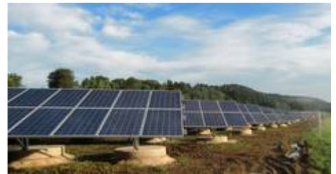
Fotovoltaikanlage, Foto: Johannes Fischer
