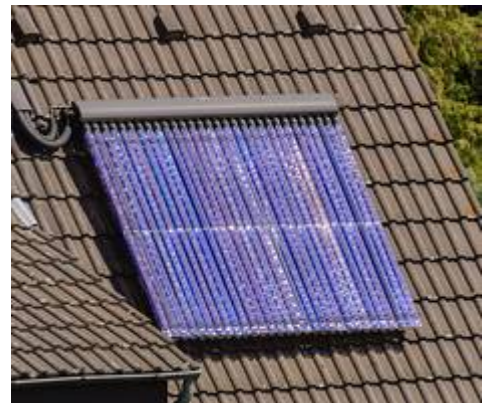
Solarthermieanlage, Foto: Norbert Nagel (cc 3.0), wikimedia commons
